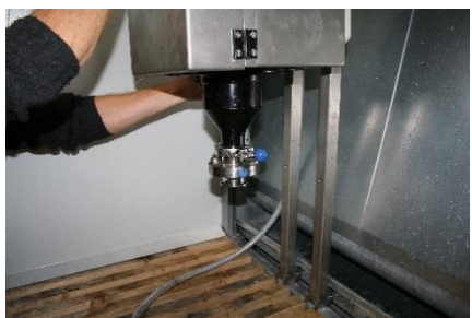
Fig. 116 Tubo flessibile di scarico rimosso
