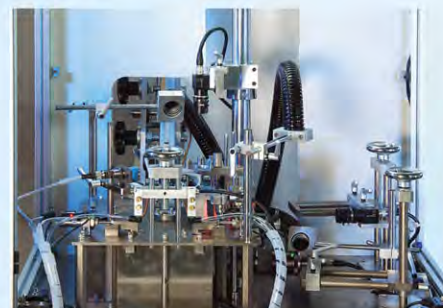
吸塵器 + 開門停機控制 LS-1504 Cleaner + Disconnection of Power Supply
