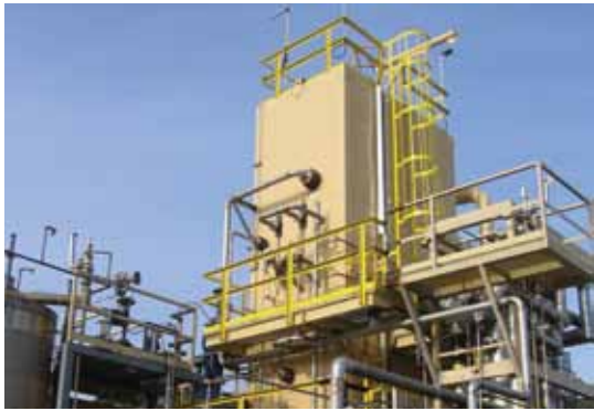
Small-scale LNG liquefaction plant
