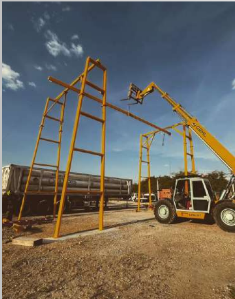
DESCARPADERO FIJO (8MTR)
